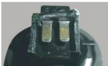
Deteriorări ale conectorilor electrici
