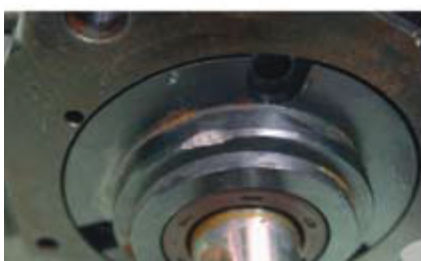
Deteriorări mecanice ale flanșei
